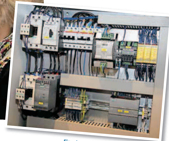
Ein wichtiger Teil des Leistungsspektrums: Die Konzeption und Umsetzung von Schaltanlagen. Foto: HWK
